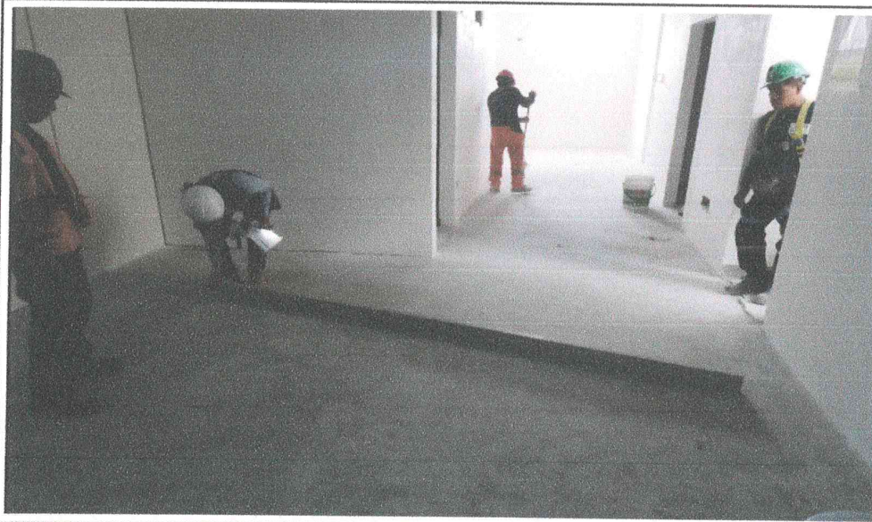
MEJORAMIENTO DE LOS SERVICIOS DE SALUD DEL HOSPITAL II-2, CESAR GARAYAR GARCIA, DISTRITO DE IQUITOS, PROVINCIA DE MAYNAS, DEPARTAMENTO DE LORETO
